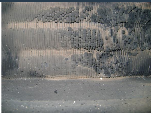
Vista interna da câmara de combustão.
